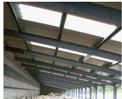
Lichtplatten im Dach des Aussenklimabereiches sollten in Hitzeperioden bei starker Sonneneinstrahlung beschattet werden.
