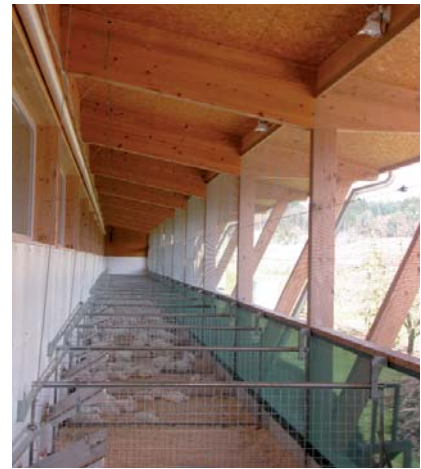
Abb. 1: Abteile des Aussenklimabereichs mit Kameras (oben rechts).
